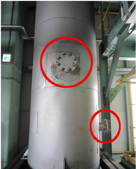
※測定位置図【排気筒 3 階部】
