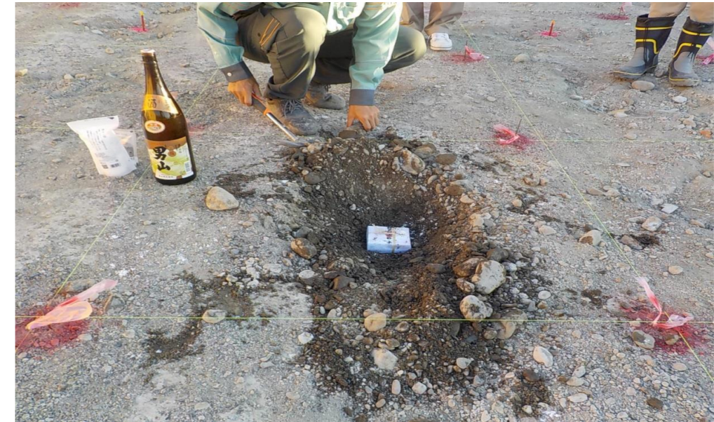
(仮称) 名寄地区一般廃棄物中間処理施設建設工事 鎮物埋納 令和6年9月30日（月）
