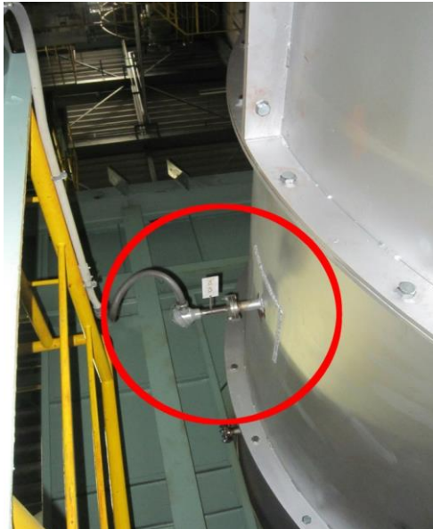
【位置図1】脱臭炉4階部
